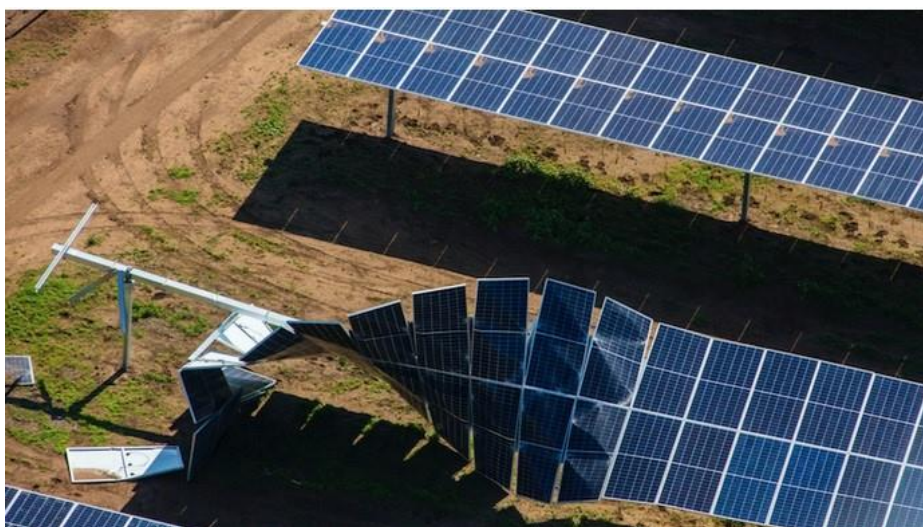
شکل ۱- تخریب سازه خورشیدی در اثر باد به دلیل مشکلات طراحی و اجرا
